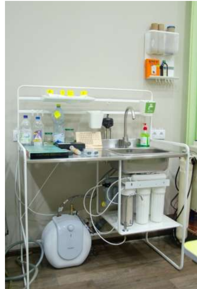
Установка зворотнього осмосу
